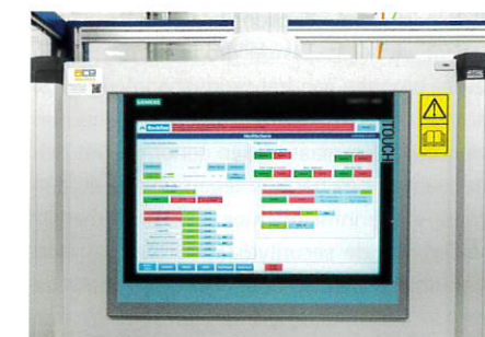
De integratie van alle meldingen en hardware-alarmen zitten geïntegreerd, wat leidt tot een beter overzicht en een hogere performantie. (Beeld: Alain Pierot)
